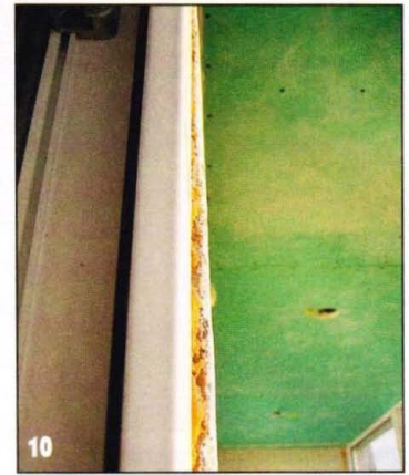
10 Откос у дверного блока возле пола на 30 мм шире, чем в верхней части.
